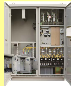
高圧受電設備
