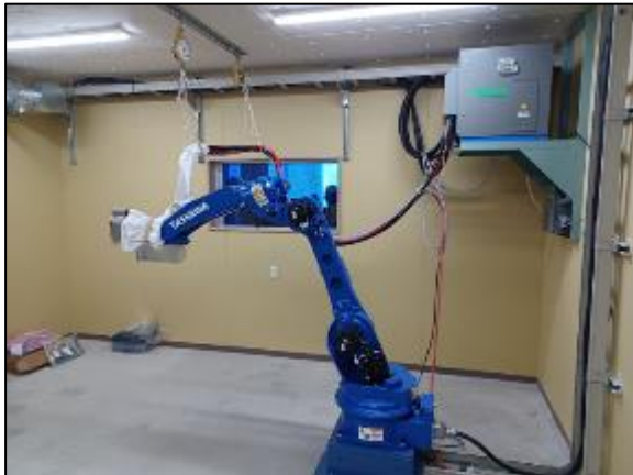
<溶射装置一式（溶射装置）>
