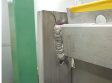
写真 2-2-14 割れ（破断）状況
