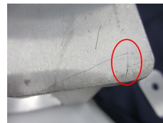
写真 2-2-7 プレート裏亀裂の拡大
