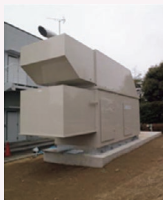
震災後導入した発電機
