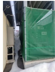
導入した 非常用自家発電機
