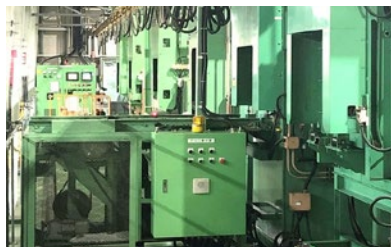
ダイレクト浸炭炉
