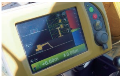
重機のコントロールパネル
