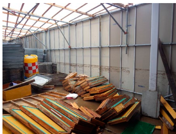
浸水の痕跡を残す資材倉庫の壁面
