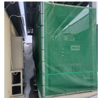
導入した非常用自家発電機
