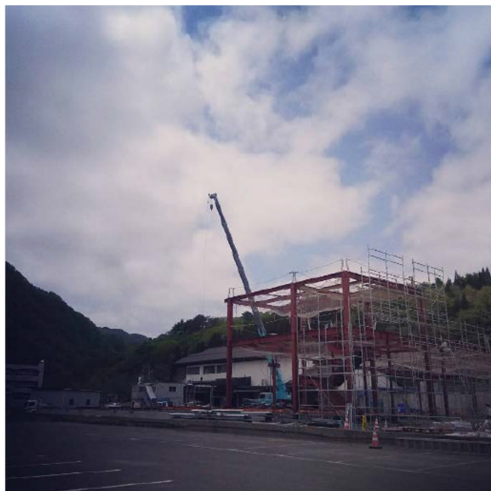
岩泉乳業第二工場 平成29年 5月12日
