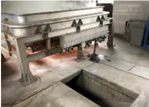
新工場内の大きな排水溝（水害・土砂対策）
