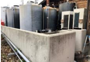
止水ブロック（高潮対策）
