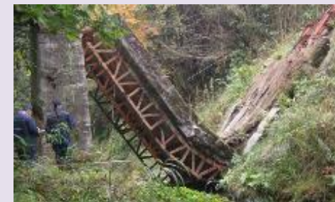
香川・徳島県境無名橋の落橋 (2007年)
