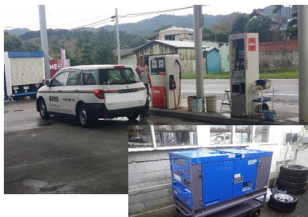
千葉県鴨川市の住民拠点SSでは、停電後速やかに自家発電設備（写真㊦）を稼働し給油を継続。通電までの期間に多数の車両への燃料供給を実施。
