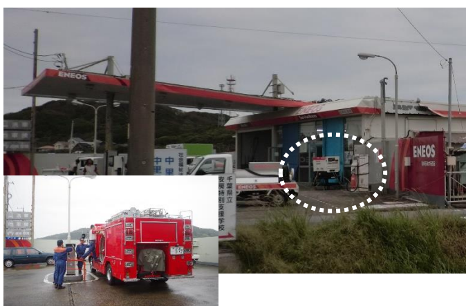
松崎石油犬石SS（千葉県館山市）では、約2週間にもわたる長期停電が続く中、可搬式の自家発電機を稼働させて、緊急車両などへの燃料供給を続けた
