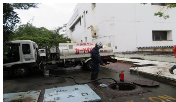
【事例2】「令和元年東日本台風」において、横浜市からの燃料供給要請を受け、ポンプ場への燃料油供給を実施
