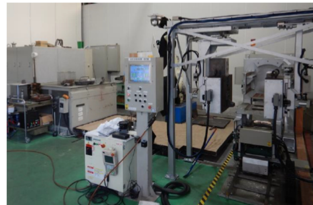
鋳造実験プラント(鋳造自動化装置) (高周波誘導炉、溶湯ハンドリングロボット、 鋳造装置から構成)
