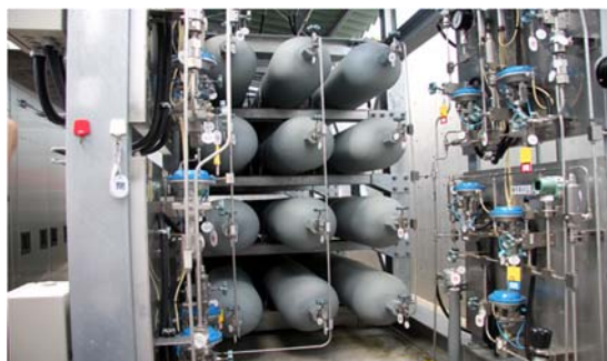
図 1-1-2 商用水素ステーション配管
