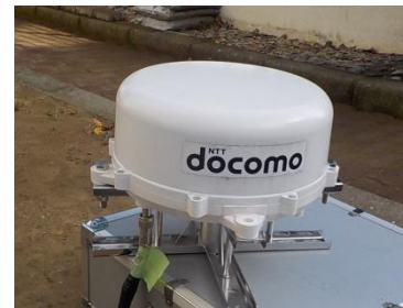
図26 使用した衛星通信のアンテナ写真
