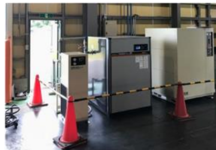
窒素ガス発生装置
