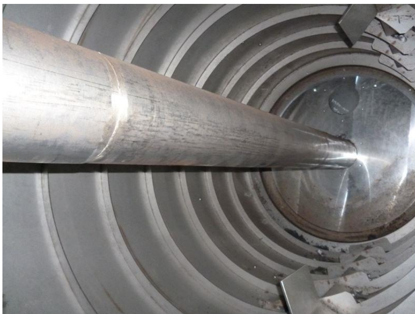
図67 吹き出しパイプ
