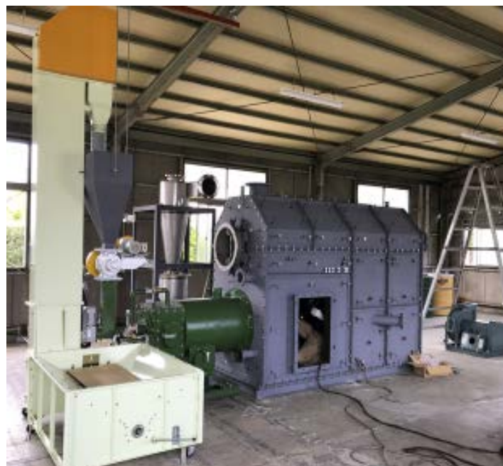
写真2-3 一体化ガス化炉テスト装置
