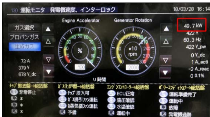
写真 2-6 発電モニター
