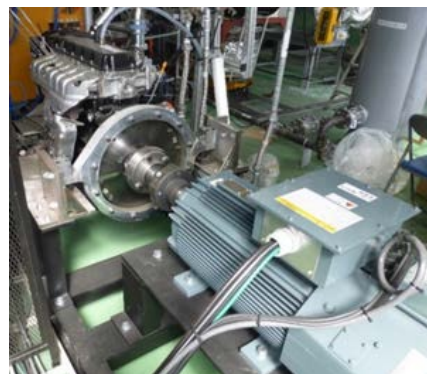
写真 2-7 バイオマスガスエンジン・発電機
