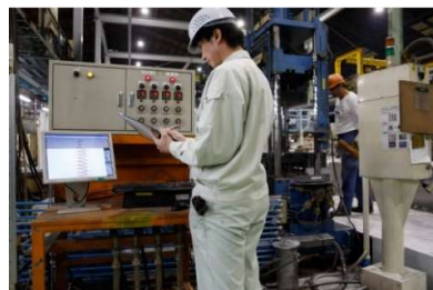
写真3：温度管理システム
