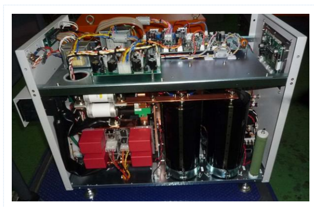
図6. 異種金属溶接用電源装置の内部写真
