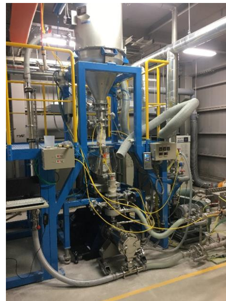
図 粉体自動移送システムの外観
