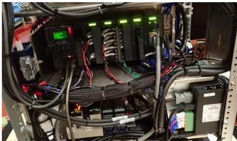
図 2 4 処理室（角形真空容器）下部に収納された制御システム一式。
