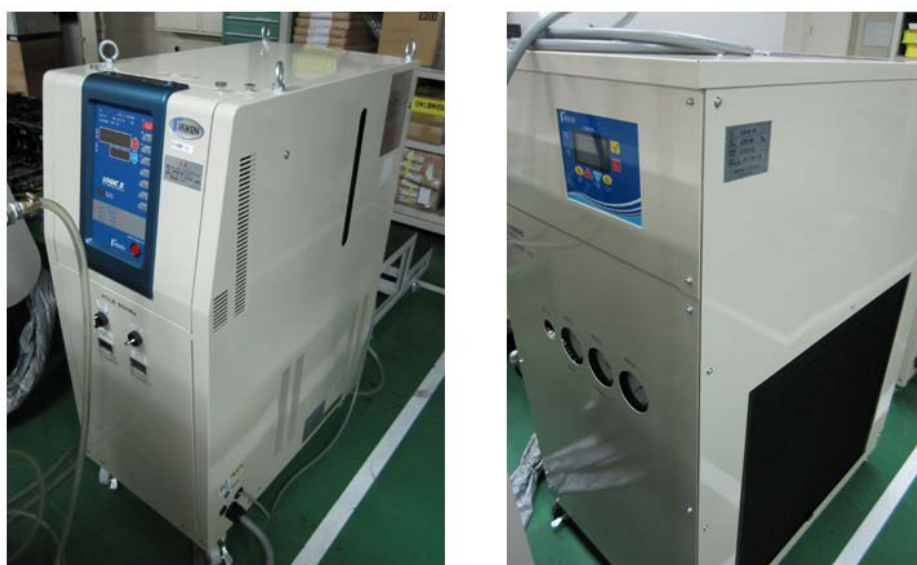
写真 2.19 温調機器（左：負圧式加温機、右：冷却器）
