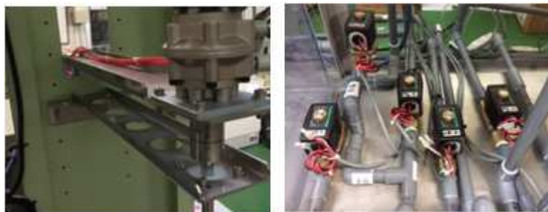
図58. テストライン用軸ブレ防止シャフトおよび縦積層型水洗槽用電磁弁
