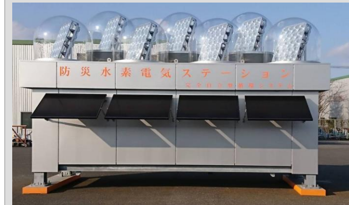
ソーラー水素蓄電システム
