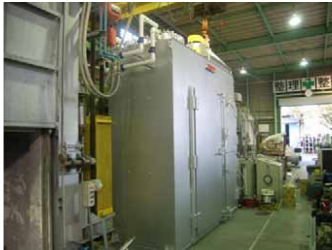
図 2-1. 圧延用加熱炉
