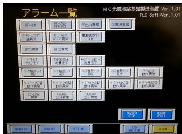
図 18：制御画面 (ALARM)
