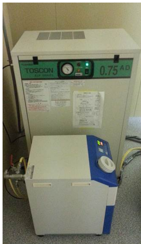
図14：エアコンプレッサーおよびチラー
