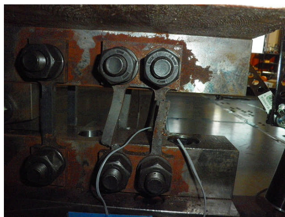
b) 中柱外側ダンパーが2枚とも破断した例
