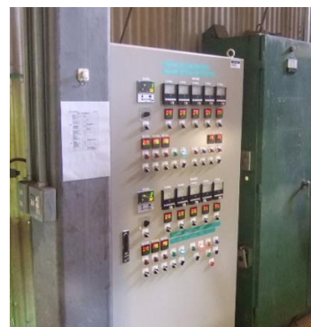
図 2-1-1-3 金型昇温制御システム
