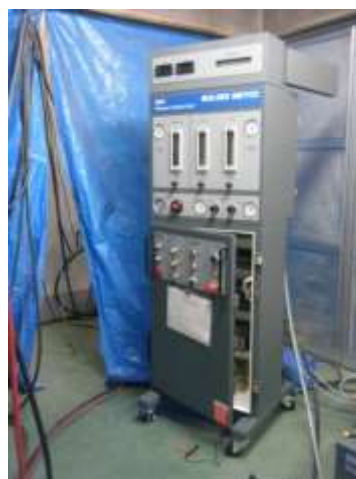
(b) プラズマ溶射装置 制御盤
