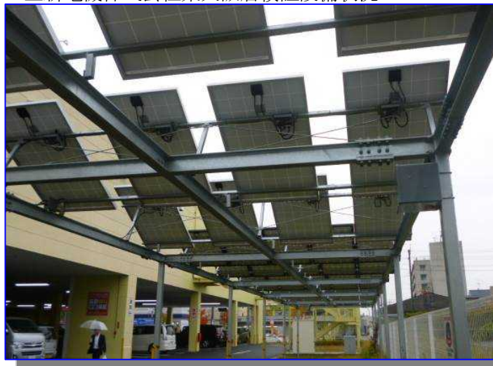
上新電機株式会社東大阪店検証設備状況
