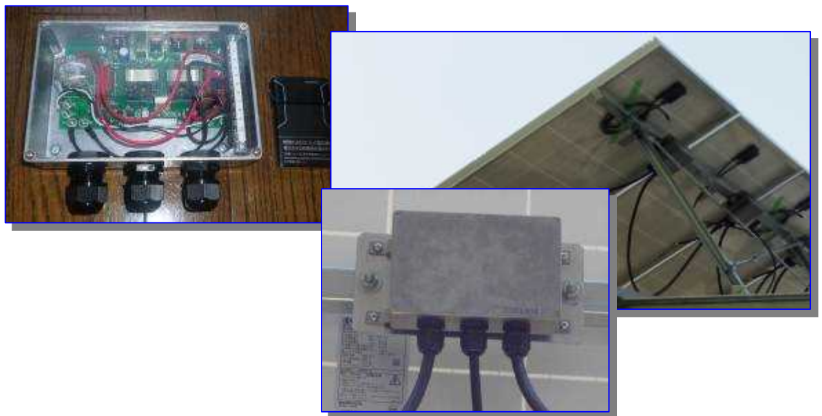
分散型 MPPT デバイスを取り付けた状況
