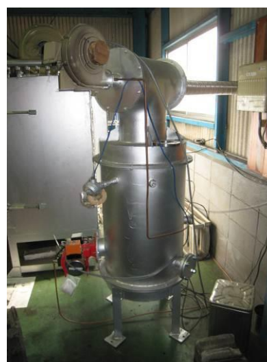
図30 設計・開発した排ガス処理装置
