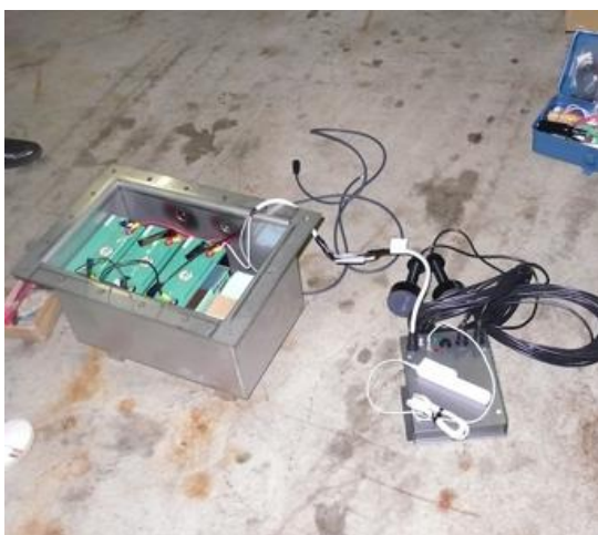
図 2-2-29 収納ボックス・バッテリー及び監視装置
