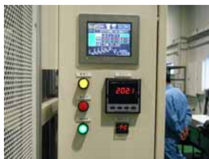
(c) 制御コントローラ部
