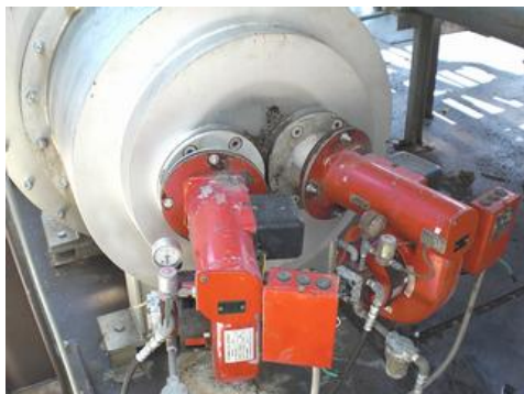
写真2-4-2 オイルバーナー （固形肥料化設備）
