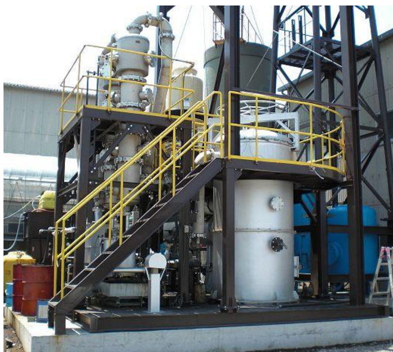
写真 2-4-1 固形肥料化設備
