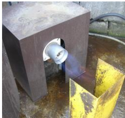
写真2-4-3 バイオガスバーナー （燃焼のようす）
