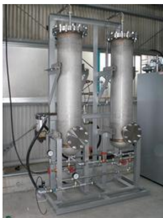
メタン濃縮装置
