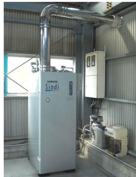
写真 2－1－2：蒸気ボイラー (プロパン・バイオガス併用型)
