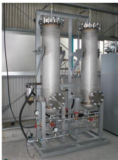
写真 2-2-1 : メタン精製・濃縮装置
