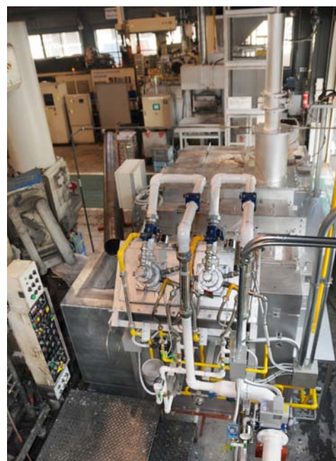
図 12-2 装置（保持室・ラジエント供給装置（投入室側） バーナー側）
