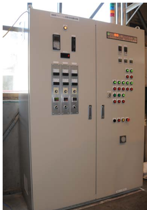
図 12-5 装置制御盤、空気・ガス配管
