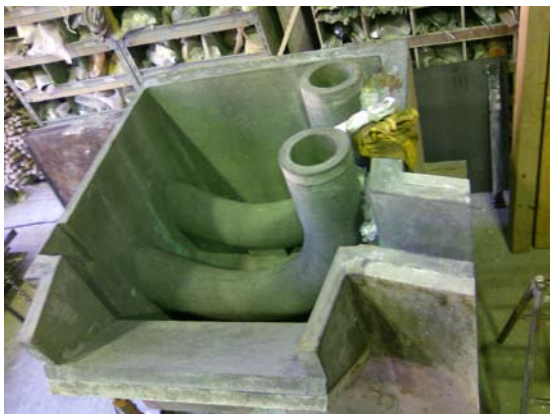
図 6-1 溶解室ラジアントチューブ
