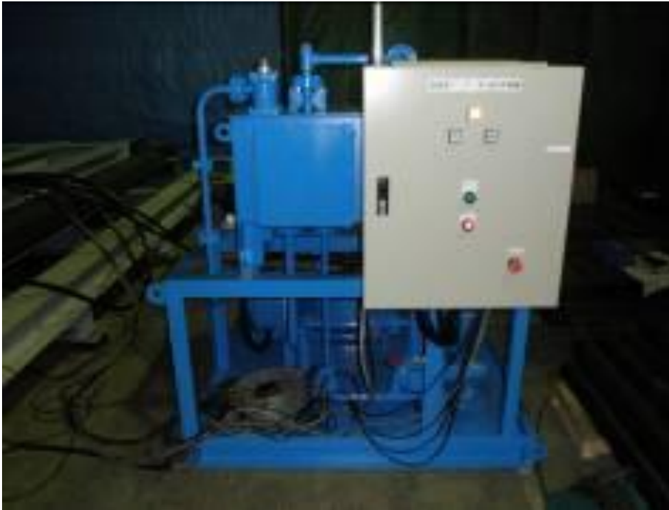
図 2.4.7 油圧ユニット
