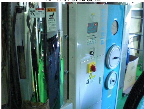
16 材料供給装置
