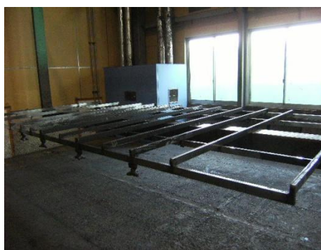
写真 9：塗型作業台の歪み
