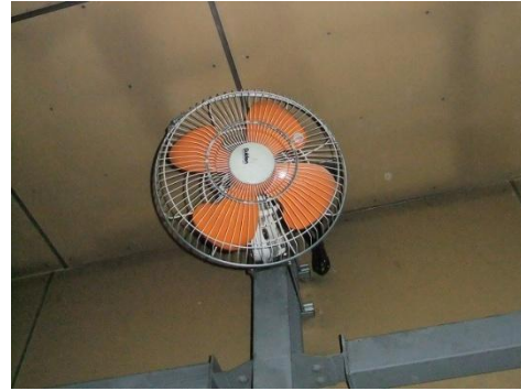
写真 14：天井からの送風機
