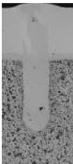
図 2-5-2 重ね継手の溶接部マクロ写真
