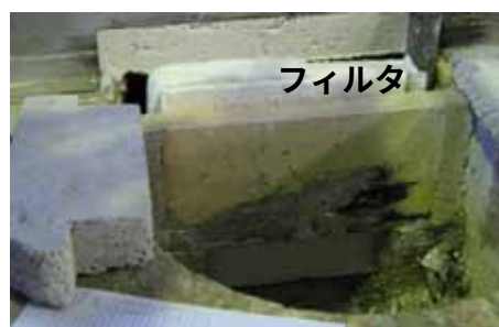
図 2-3-1 改良型フィルタ設置上部
