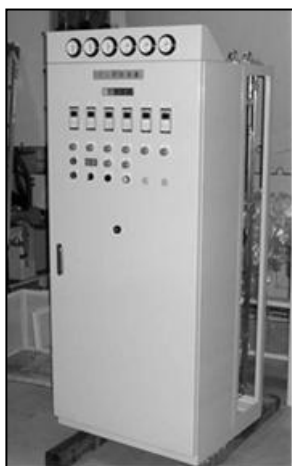
図 3.4 ガス供給装置の外観
