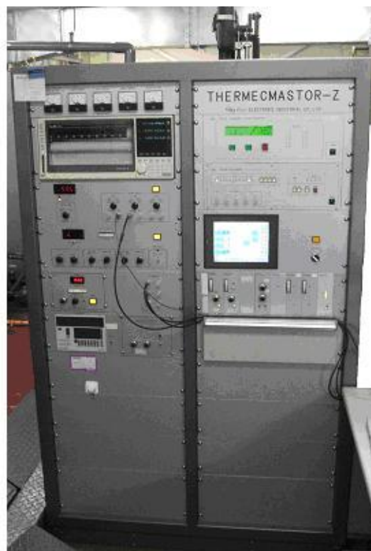
制御操作盤本体
