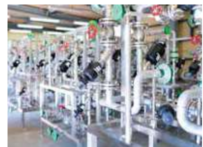
純水製造装置
