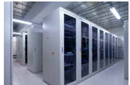
多数のサーバーが稼働するデータセンター
