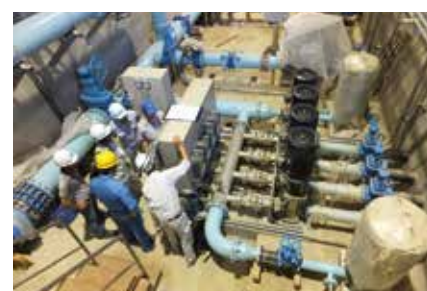
カンボジアの浄水場のポンプ室
