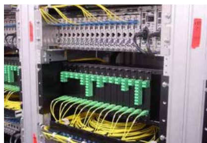
データセンタ内の光配線
