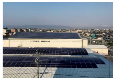
工場屋根に設置した太陽光パネル
