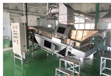
最新の蒸米機・放冷機
